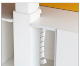
Subida cables PE.
